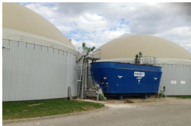
Fig. 3. „Bio Ziedi” biogas plant
